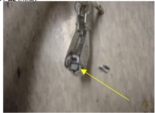
本体破損(固定ぎぼし側)
